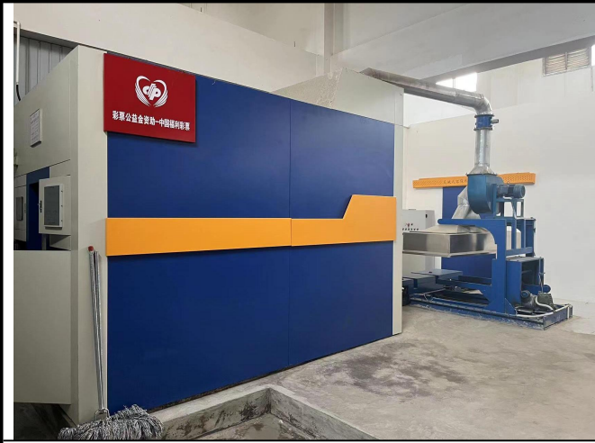
本次扩建火化机（未运行）
