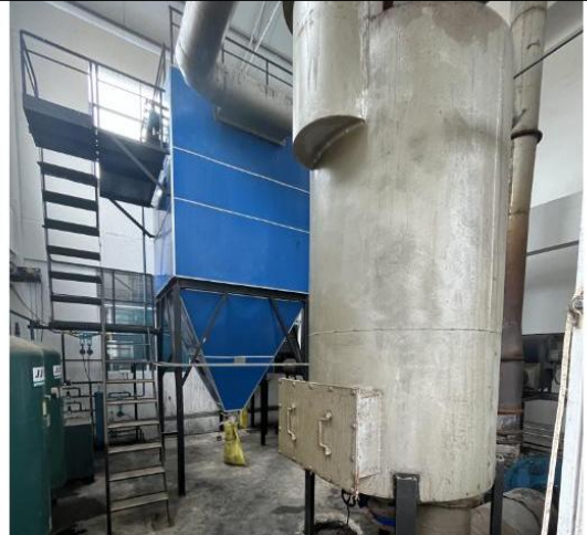
现有工程火化机尾气处理装置
