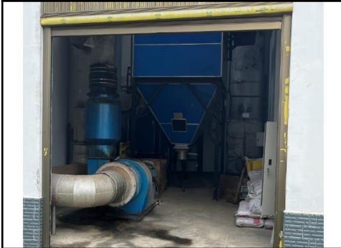
现有工程已建遗物焚烧炉尾气处理装置
