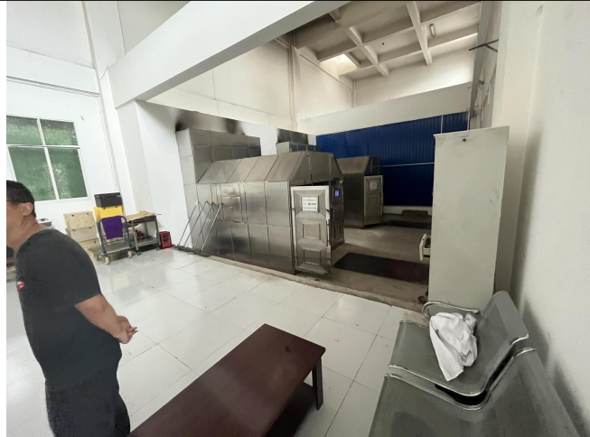
现有工程火化炉（2台）
