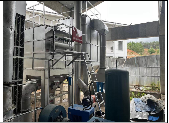
本次扩建火化机配套尾气处理装置
