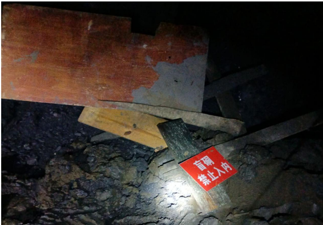
(图八) 已破坏的封堵栅栏
